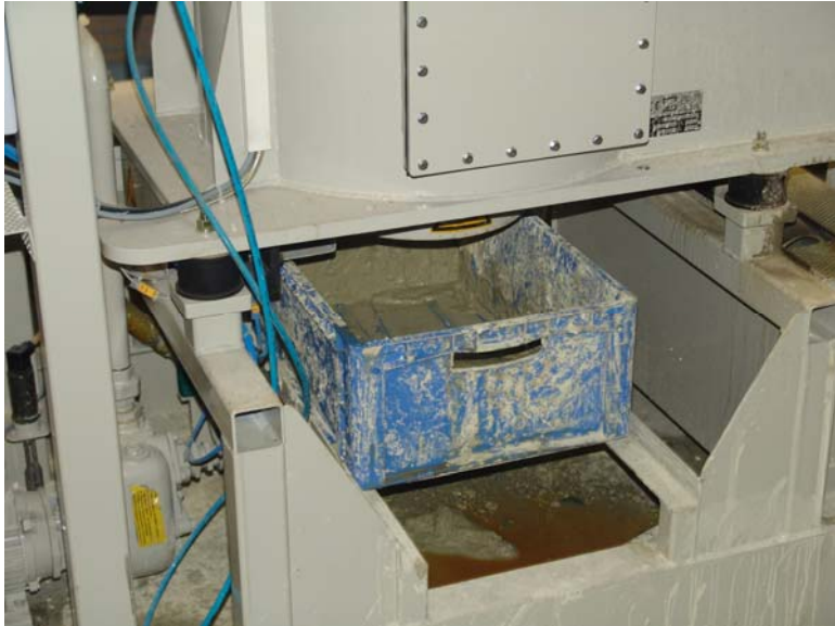
Foto 3 (050916-06) Vollautomatisch kratzt die Zentrifuge den Schlamm von der Trommelwand und lässt ihn per Schwerkraft in einen Auffangbehälter fallen, der nur einmal pro Schicht geleert werden muss.
