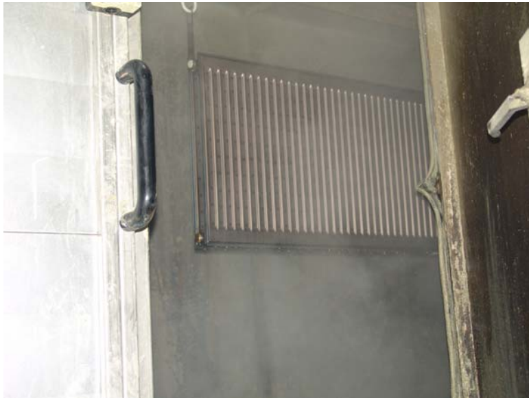
Foto 5 (050916-12) Blick hinter die Kulissen: In der 5-Zonen-Anlage werden die Heizkörper entfettet und phosphatiert.
